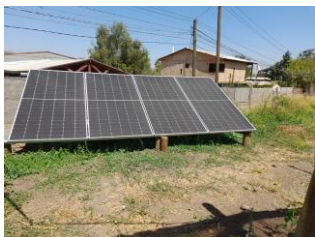
Panel solar que proporcionara energía para su funcionamiento
