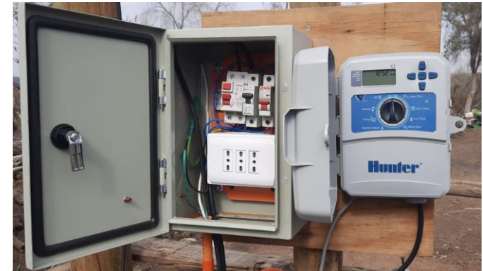
Instalación eléctrica para bomba de riego
